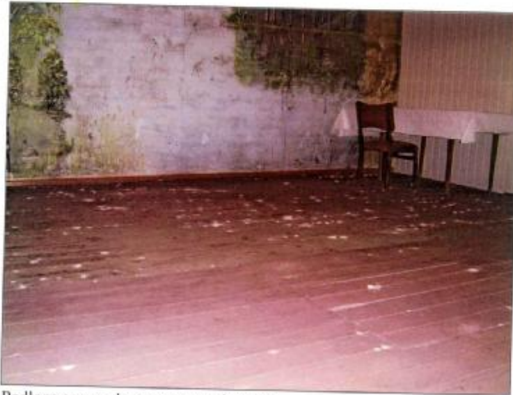
Podłoga sceny niszczona przez korniki.
