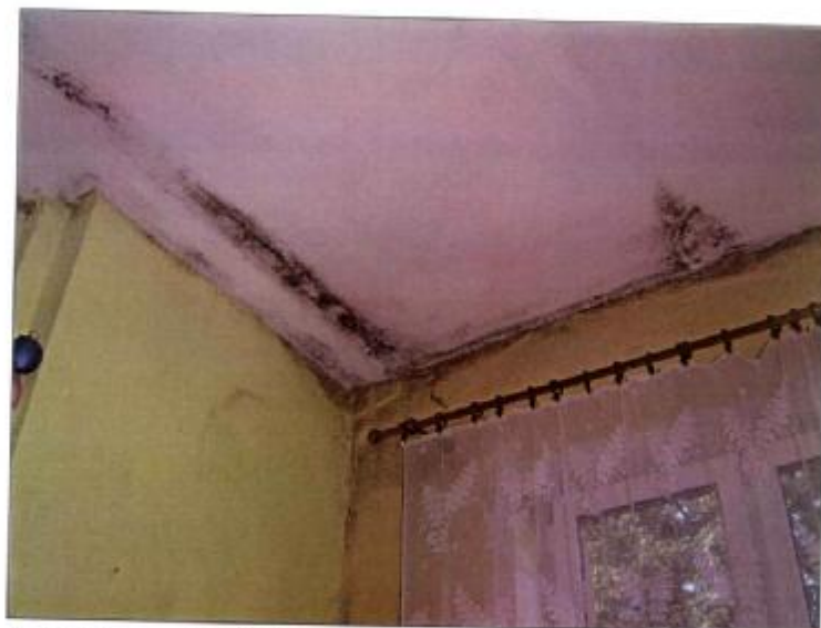
Zagrzybiony sufit świetlicy.
